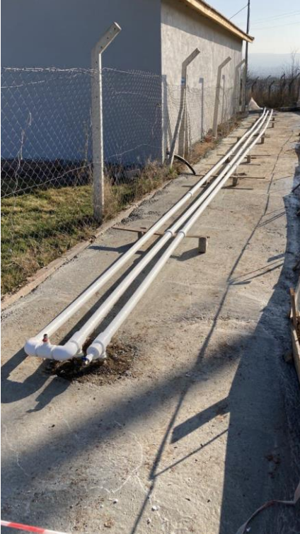
Görsel 7 Sondaj Eşanjörleri üst bağlantı (05-02-2021)
